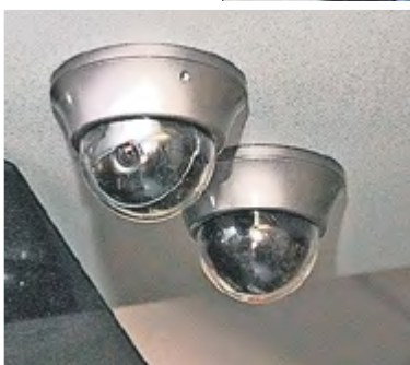
Die installierten Kameras sind nicht zu übersehen.
